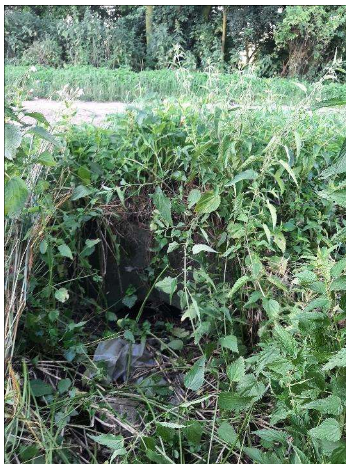
Obr. 18: Odvodňovací příkop „Šafránice“, zanesený propustek pod cestou od Štulbachu k Beňovu
