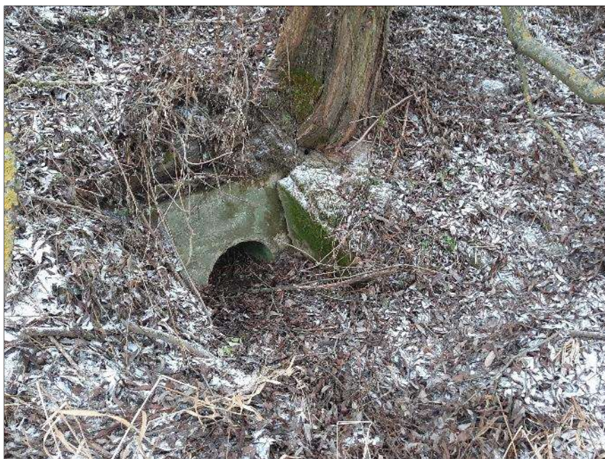
Obr. 38: Částečně zanesený patrně nefunkční výústek V1 systematické odvodňovací drenáže v lokalitě Bařina. Výústek je společný s kanalizací dešťových vod z příkopu silnice do Beňova
