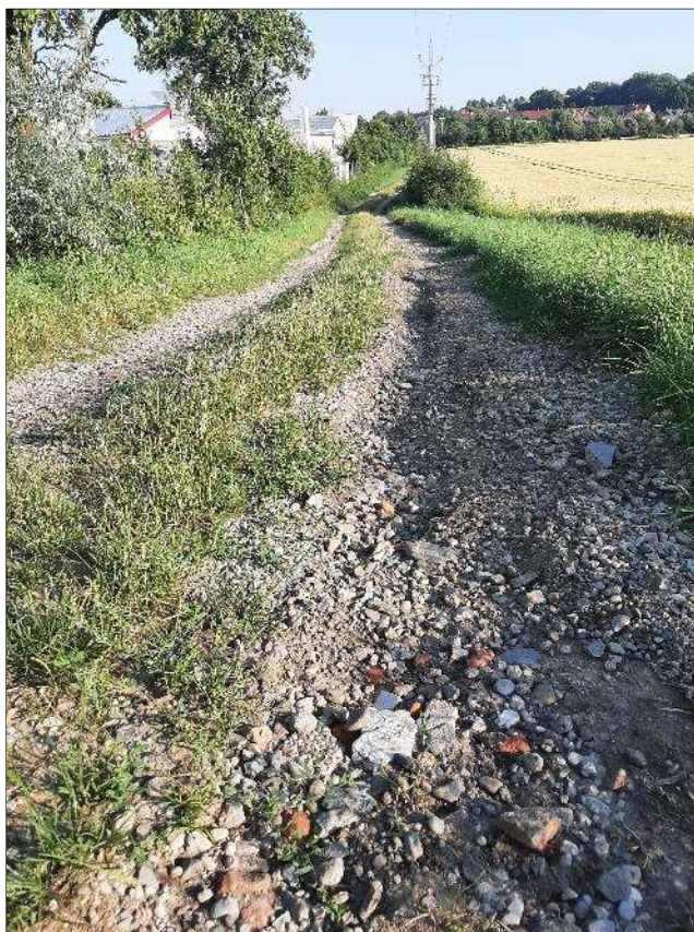
Obr. 30: Stružková eroze na polní cestě, nad areálem Hanácké kyselky, 07/2021
