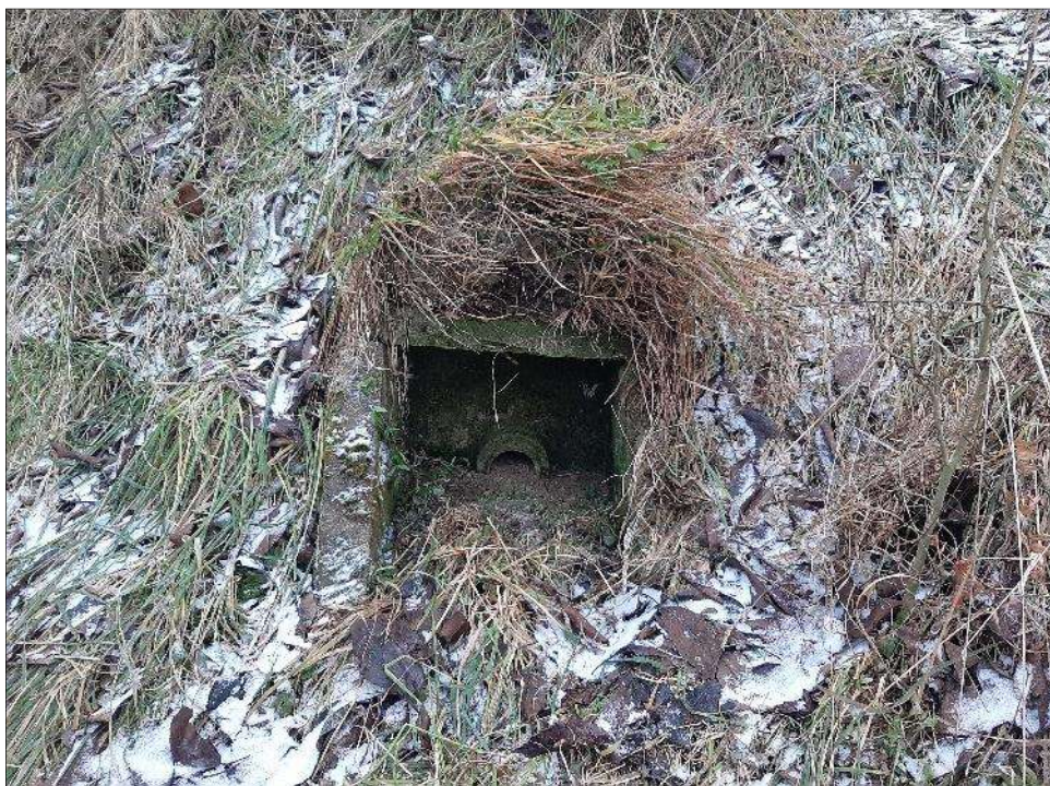
Obr. 37: Zanesený pravděpodobně nefunkční výústek V3 systematické odvodňovací drenáže v lokalitě Bařina
